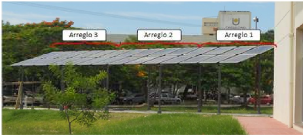
Figura 1: Pérgola solar instalado en el acceso al edificio de Ingeniería.
