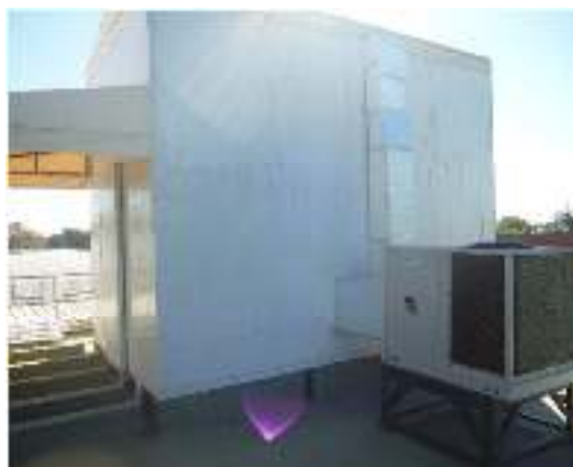
Figura 4: Vista General del Equipo HVAC
