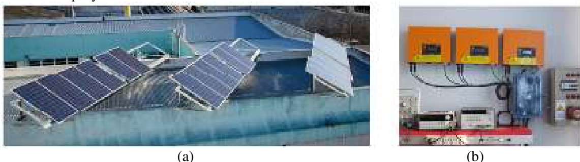
Figura 1: (a) Planta FV experimental instalada en la terraza del edificio principal de la Facultad de Ingeniería de la Universidad Nacional de Mar del Plata. (b) Inversores utilizados en la planta FV experimental instalada en la terraza del edificio principal de la Facultad de Ingeniería.
