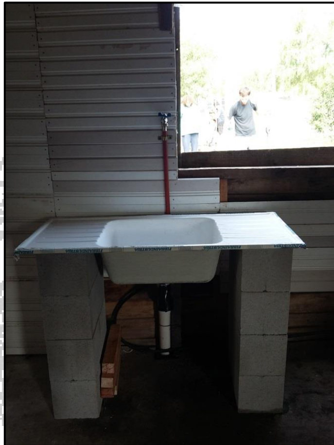
Foto N° 12: Bacha instalada en el comedor - copa de leche
