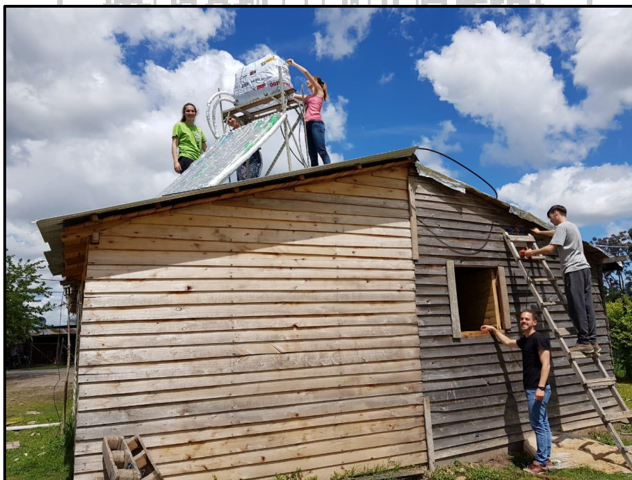
Foto N° 5: Calentador solar instalado
