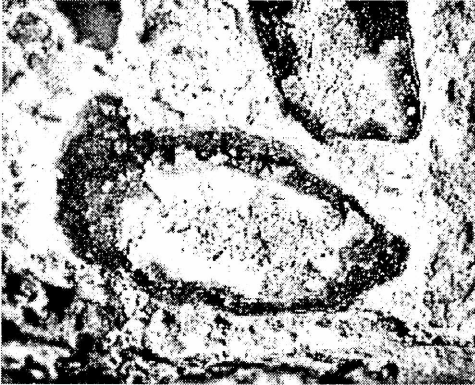
Fm7. Hormigón deteriorado por la RAS . El proceso de reacción afecta a los clastos y al mortero
