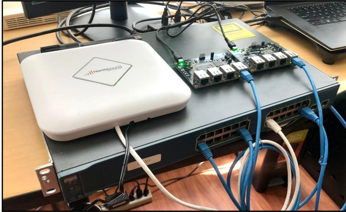
Figura 5-6 Red Física SDN implementada mediante Zodiac FX(2), Zodiac WX y Controlador RYU – Inicio de Cableado Fuente: Autor
