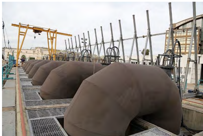
Figura 6.30: Descarga al Riachuelo de la Estación de Bombeo número 2, con 8 bombas, en La Boca-Barracas, CABA
