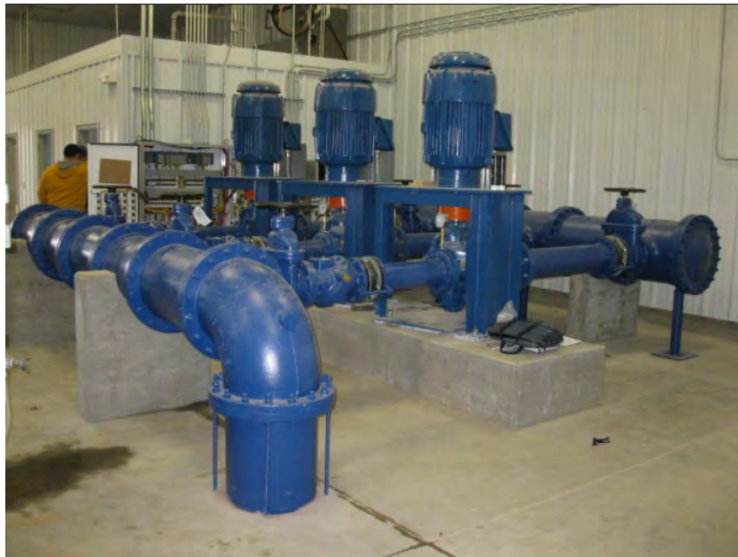
Figura 2.25: Instalación real de bombas en paralelo (fuente: https://bit.ly/3wA8KRI )
