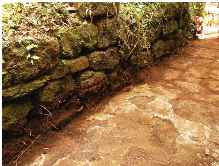
Figura 9. Muro de contención y pavimento con sectores con cemento
