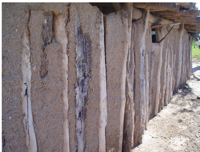
Figura 6. Casa Silva: muro de palo a pique con revoque de barro perteneciente al recinto desmantelado en mayo de 2014 (foto de 2005). Fotografía: Constanza Taboada
