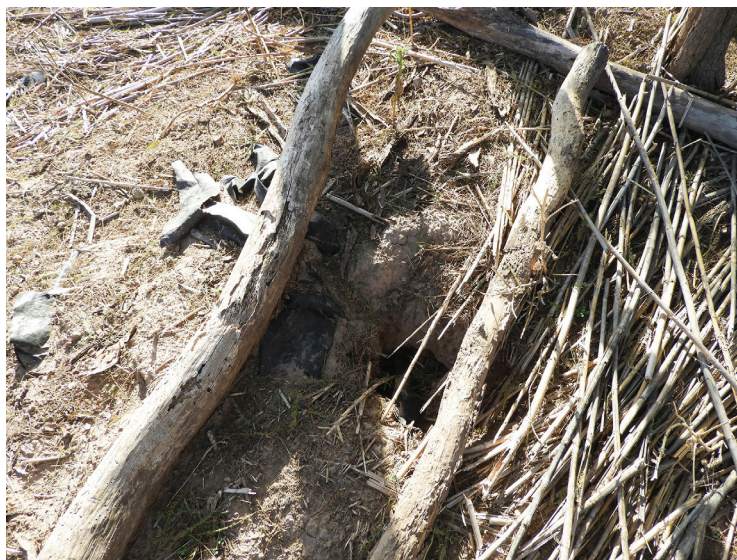
Figura 18. Casa Carrizo (agosto 2022): hoyo de horcón reabierto para extraerlo y restos de construcción desarmada sobre el piso. Fotografía: Constanza Taboada
