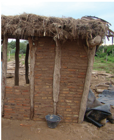
Figura 14. Casa Silva (mayo 2014): construcción de muro de ladrillos entre postes. Fotografía: Constanza Taboada
