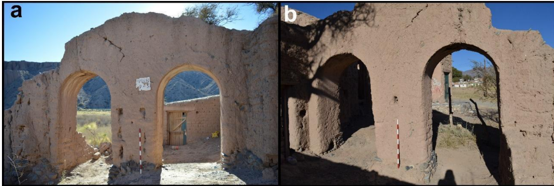
Figura 6.17: muro SE del R4 y las dos arcadas de medio punto. Referencias: (a) vista desde el exterior y su vínculo con la puerta de ingreso de la habitación de molienda o R6; (b) vista desde el interior.
