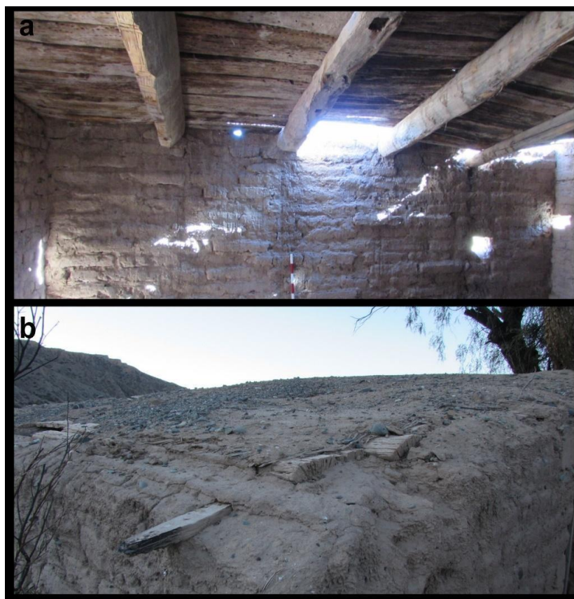
Figura 6.30: techo del R6. Referencias: (a) vista interior del techo con vigas de algarrobo con evidencias de deterioro; (b) vista exterior del techo con evidencias de nuevas capas de adobe.
