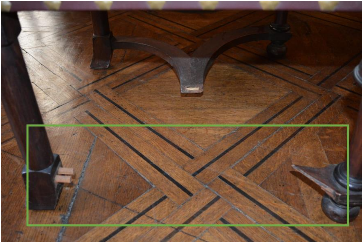
Figura 16. Mesa de estilo. Ejemplo de faltante en parante estructural de unión en sección inferior. Registro fotográfico de Luis M. Ferreyra Ortiz
