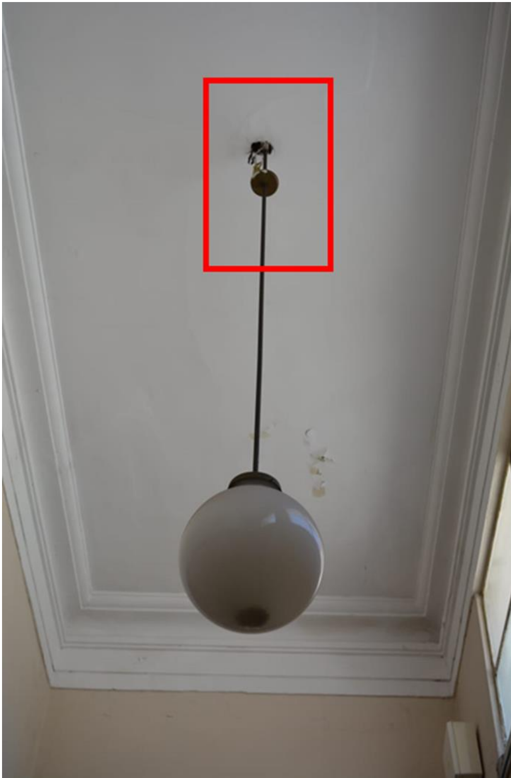
Figura 18. Ejemplo de tapa eléctrica suelta en sección superior. Registro fotográfico de Luis M. Ferreyra Ortiz.
