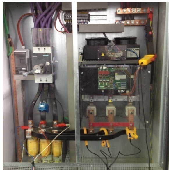
Fig. 7. Conexionado del equipo de registro en el tablero de alimentación del rectificador de la trefiladora.
