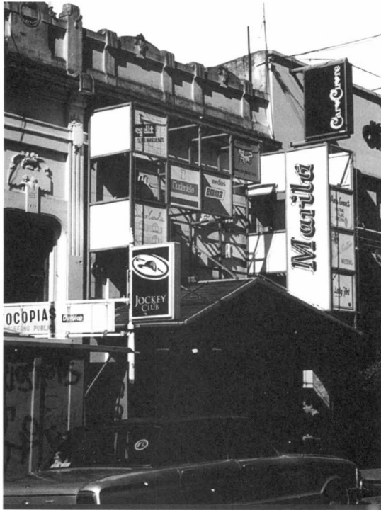
Calle 8 entre 45 y 46. Destrucción de la fachada original por la superposición de publicidad y estructuras metálicas
