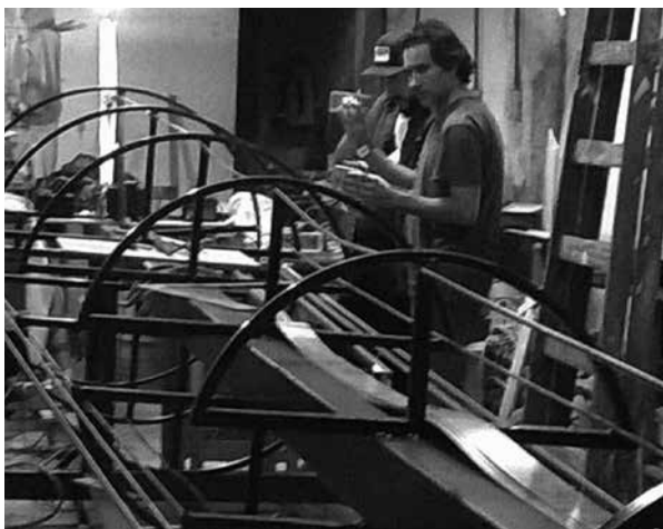
DI Néstor Bertotto construyendo la estructura de torre metálica, el plafón y el sistema de movimiento
