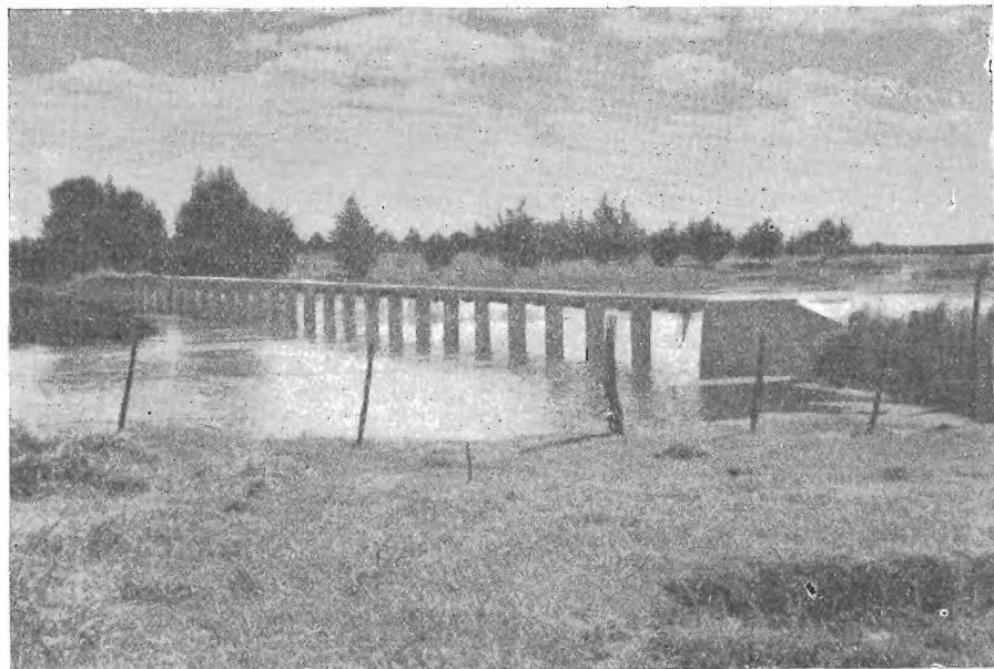
Fig. 28.—Compuerta de la laguna Vitel rebalsada por el agua. (Foto L. Ferreyra, octubre de 1958)
