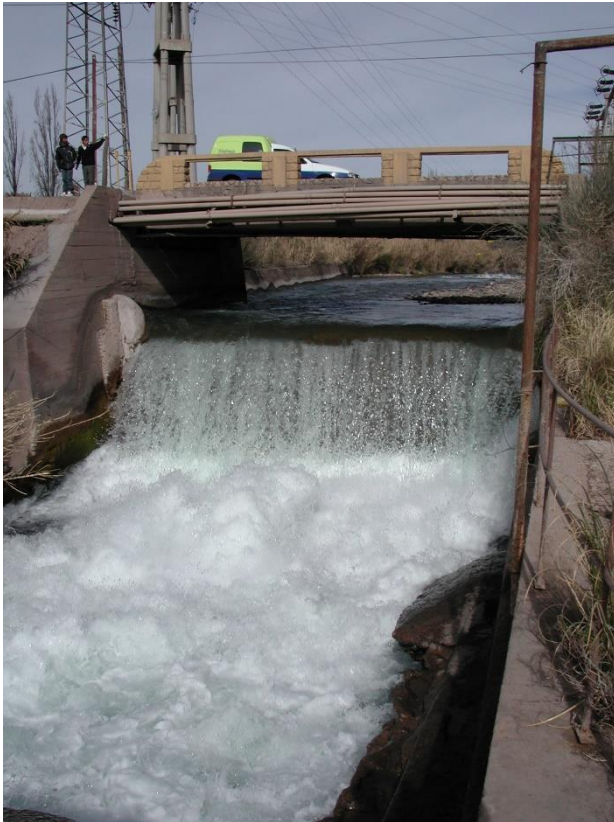
Figura Nº 7. Salto de agua en el canal Zanjón.
