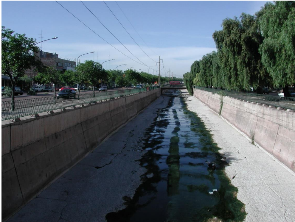
Figura Nº 9. Tramo donde se ve el Zanjón canalizado durante su paso por la ciudad de Mendoza. Foto propia.
