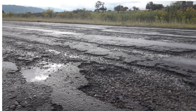
Fig. 1. Baches de gran magnitud en carreteras.
