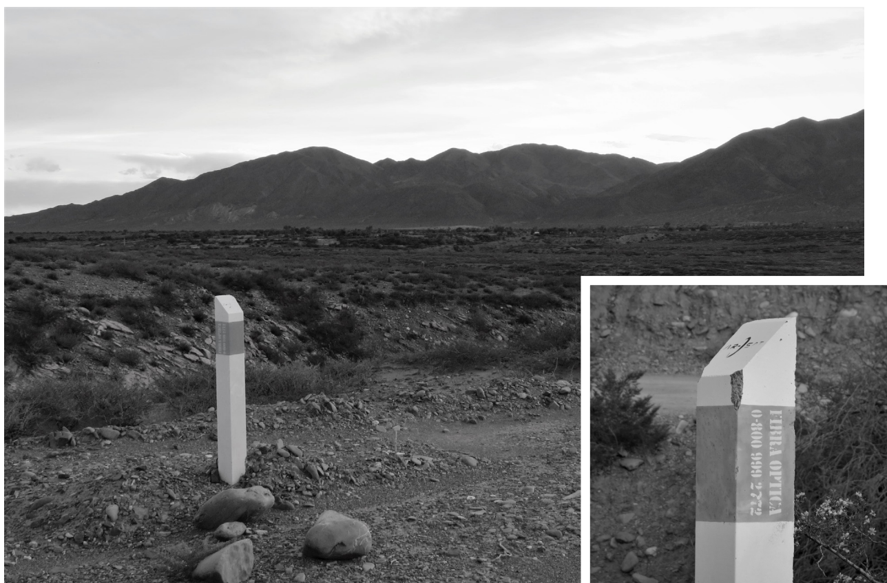
Hitos de hormigón utilizados para la identificación del enlace de fibra óptica y las cámaras de paso y de empalme. Colocados cada 1 Km. La foto fue tomada en el km 4551 de la ruta 40 (Provincia de Salta)
